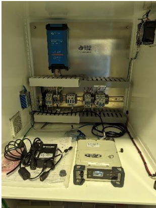
Figura 3. Vista interna del Gabinete
