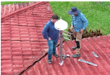
Figura 1. Estación CORS con su respectivo Domo.
